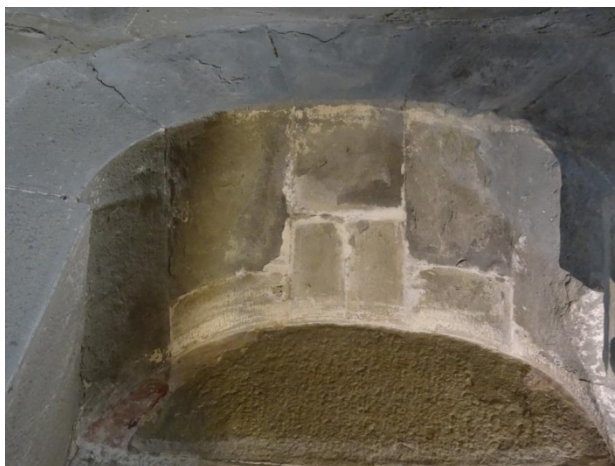
Foto 15: zona del sottarco dopo la rimozione di alcune efflorescenze ed imbianchimenti.
